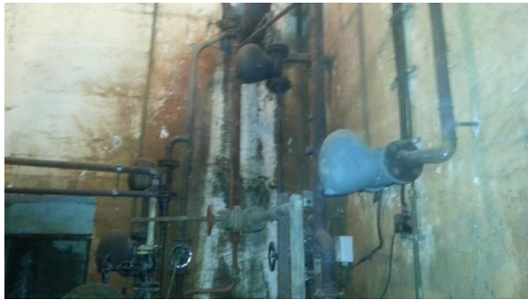
Výměníková stanice a rozvody páry v 1PP
